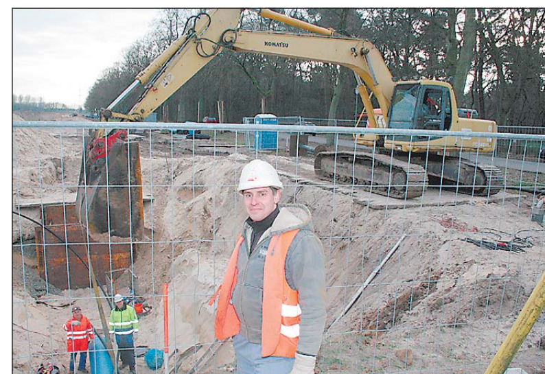
Rohrleitungsbauer Matthias Busse (vorne) weist Stahlschweißer Fiore Petrarca und den Auszubildenden Michael Völker (von links) bei der Arbeit an der neuen Wasserleitung ein, die zurzeit an der Kampstraße verlegt wird.
