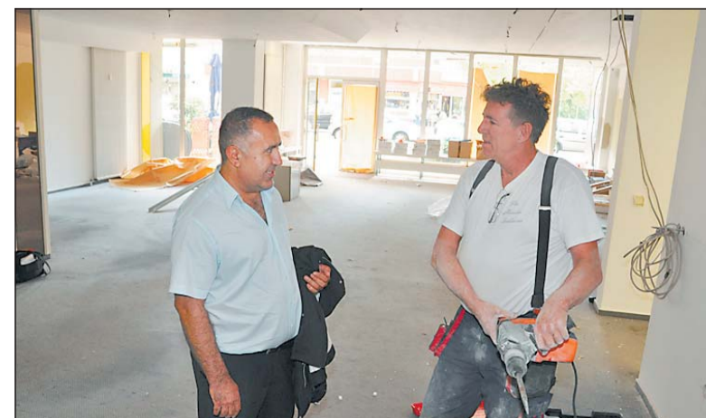
Die Trockenbauarbeiten haben begonnen: Immobilienbesitzer Hasan Atalan (links) und Installateur Peter Maureschat besprechen den Einbau von Küche und Sanitäranlagen. Fotos: Markus Poch
